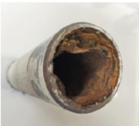
Korrodiertes, verkrustetes Rohr
